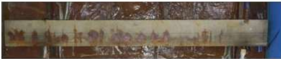
Gambar Balok Korosi ECC
