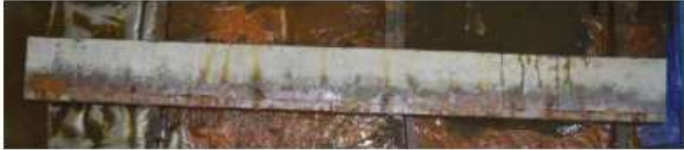
Gambar Balok Korosi NC
