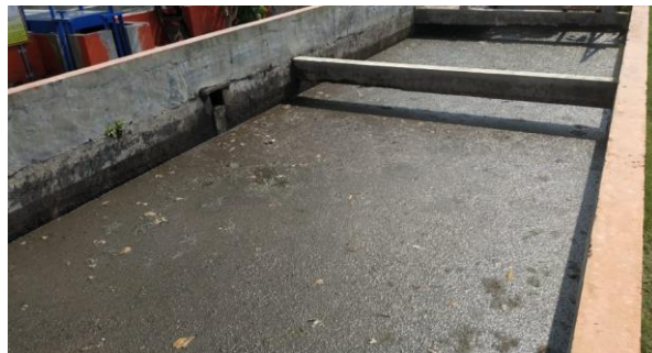
Gambar 3. 4 Kondisi Eksisting Balancing Tank
