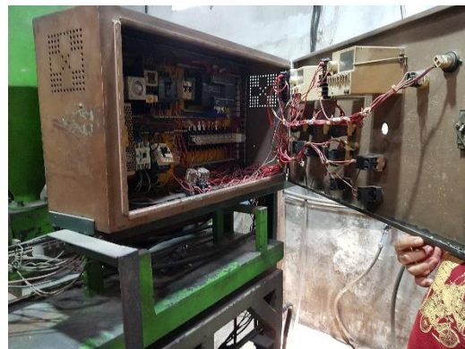
Gambar 8. Ruang kontrol mesin
