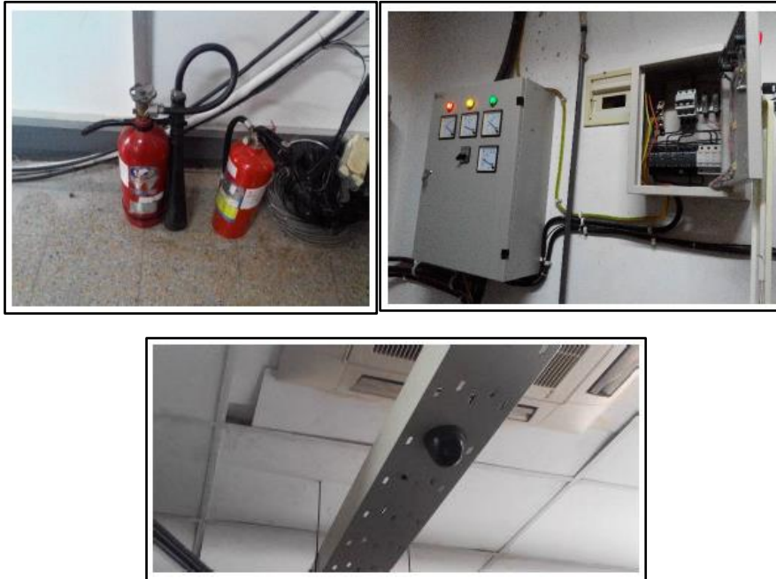
Gambar B.18 Tabung Gas Pemadam Kebakaran, Box Panel Listrik, dan CCTV
