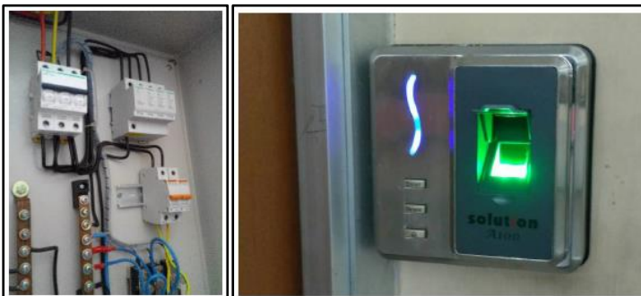
Gambar B.37 Grounding dan Fingerprint pada Ruang Server
