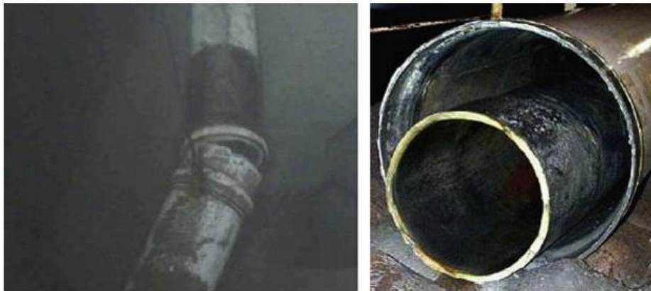
Gambar 2.6. Pipeline yang Mengalami Fatigue (Bai, 2014)
