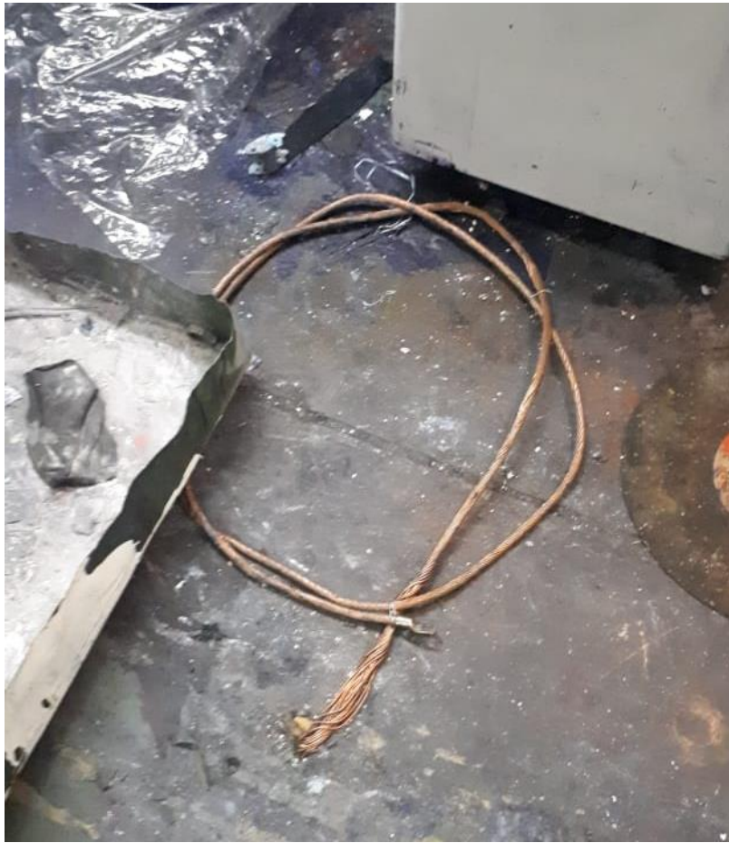
Gambar 5.4. kabel tembaga yang menyambung ke tombak grounding
