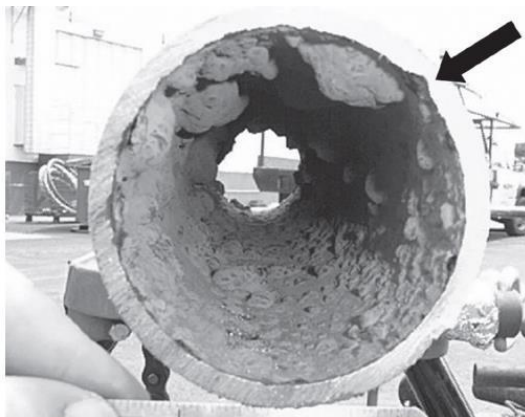
Gambar 2.2 Korosi sumuran pada pipa (Fontana, 1986)
