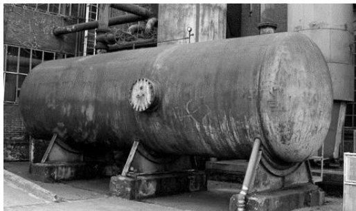
Gambar 2.1 Korosi merata pada tanki (Fontana, 1986)
