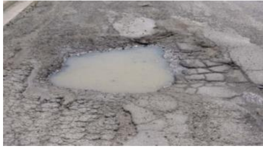
Gambar 2. 4 Kerusakan Jalan Amblas
