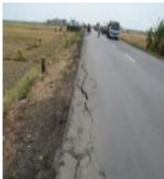
Gambar 2. 11 Kerusakan Jalan Edge Cracking
