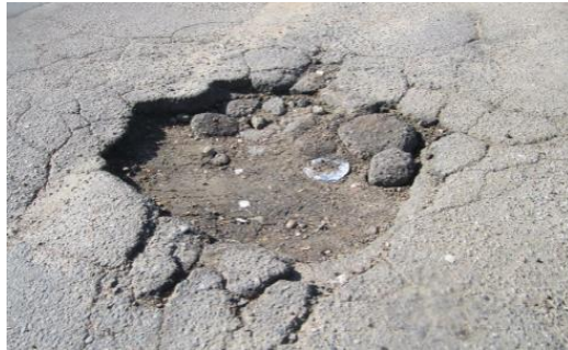
Gambar 2. 1 Kerusakan Jalan Potholes
