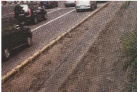
Gambar 2. 9 Kerusakan Jalan Rutting
