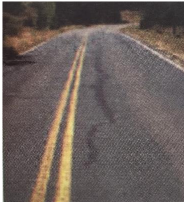
Gambar 2. 8 Kerusakan Jalan Longitudinal Crack
