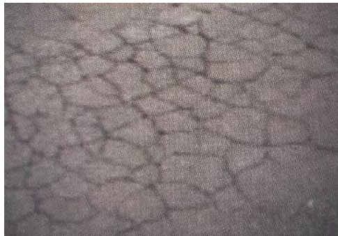
Gambar 2. 2 Kerusakan Jalan Alligator Cracking
