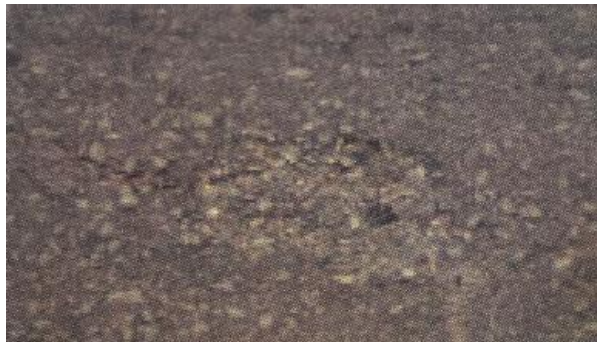
Gambar 2. 3 Kerusakan Jalan Ravelling
