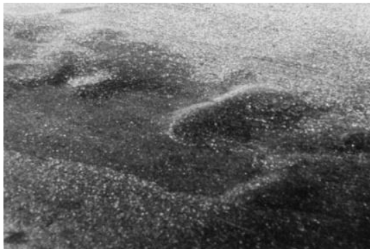
Gambar 2. 5 Kerusakan Jalan Keriting
