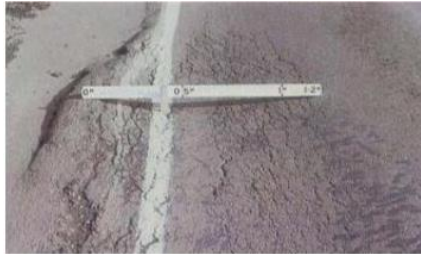
Gambar 2. 6 Kerusakan Jalan Sungkur Sumber : (Ziantono, 2016)
