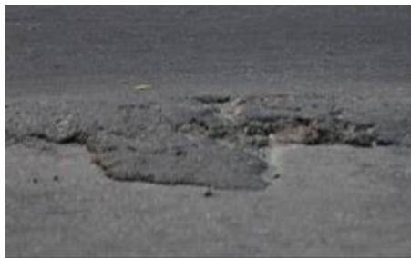
Gambar 2. 10 Kerusakan Jalan Flushing
