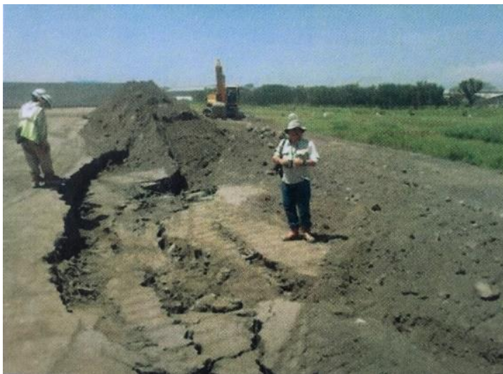
Gambar 1. 2 Kondisi Lereng Longsor Lokal (STA 15+350)
