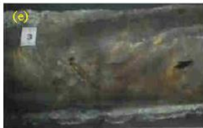
Gambar 2. 1 Kegagalan waterwall tube pada penelitian Patel Sunny Sanjay (a) waterwall tube sebelum mengalami kegagalan (b) pembengkakan pada waterwall tube (c) adanya kebocoran logam dari tube (d) adanya pembengkakan di 2 lokasi pada waterwall tube (e) adanya deposit korosi di permukaan tube dibagian yang mengalami pembengkakan. (Sanjay & Mandloi, 2016)
