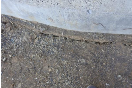
Gambar 1. 4 Keretakan Lokasi di Sekitar Base Plate (Sumber : Suwarno, 2018 )
