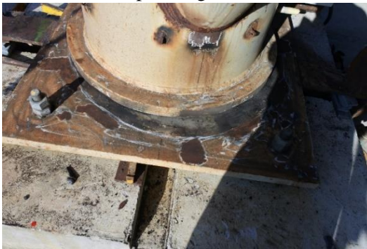
Gambar 1. 2 Bergesernya Tangki Dari Base Plate
