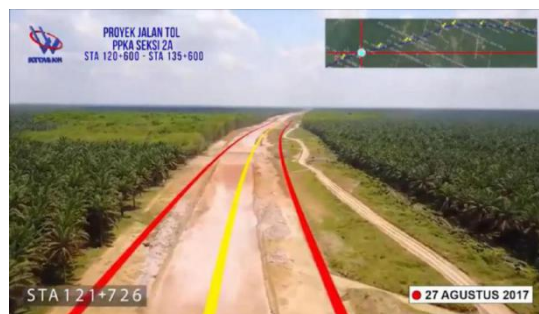
Gambar 1.1 Tampak atas rencana jalan tol Trans Sumatera Pematang Panggang -Kayu Agung, Sumatera Selatan, Indonesia (Sumber: PT Waskita Karya (Persero) Tbk)
