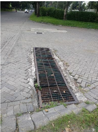
Gambar 4 Gutter Inlet di Kawasan Perumahan Dian Istana
