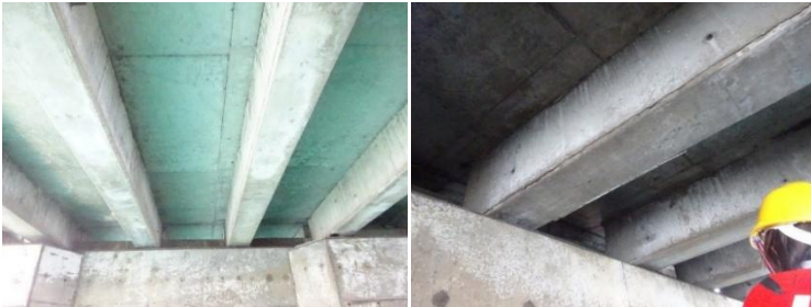
Gambar 4.5 Kondisi balok girder dan plat lantai sisi bawah masih baik tidak ada keretakan
