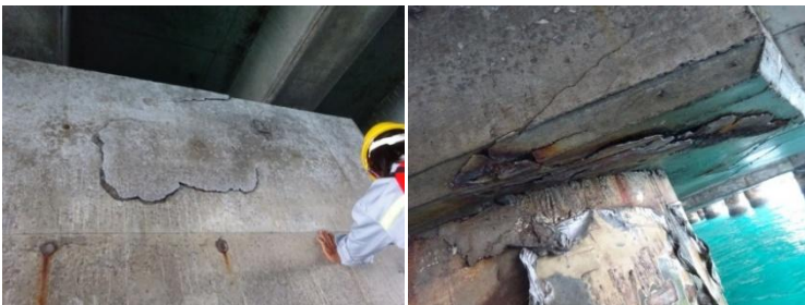
Gambar 4.6 PileCap beton mengalami retak keliling (mengelupas) dan spalling
