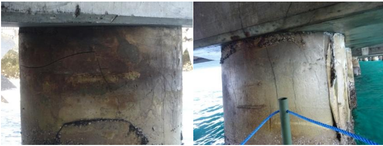
Gambar 8.39 Kondisi kerusakan jacketing mortar pancang
