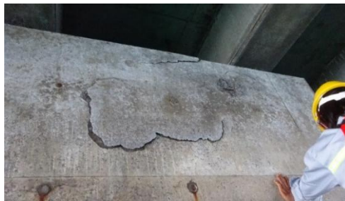
Gambar 2.9 Corrosion craks (Sumber: dok.pribadi, 2018)
