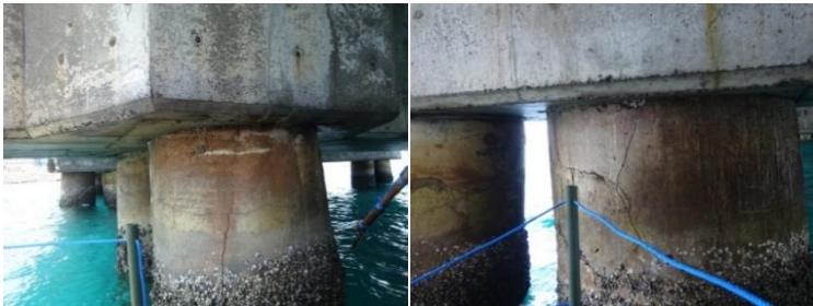
Gambar 4.8 Selimut beton pancang baja mengalami keretakan
