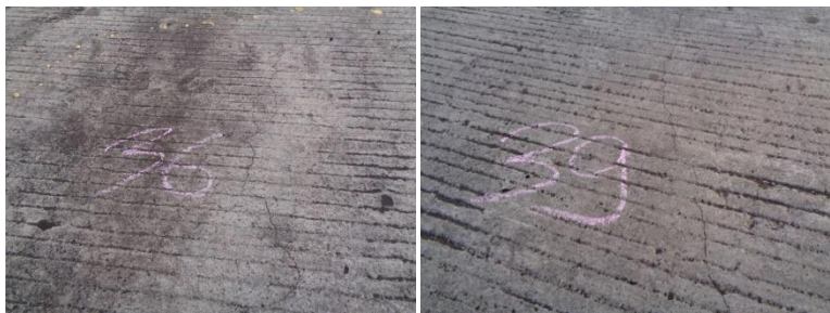
Gambar 4.4 Retak memanjang pada plat lantai trestle
