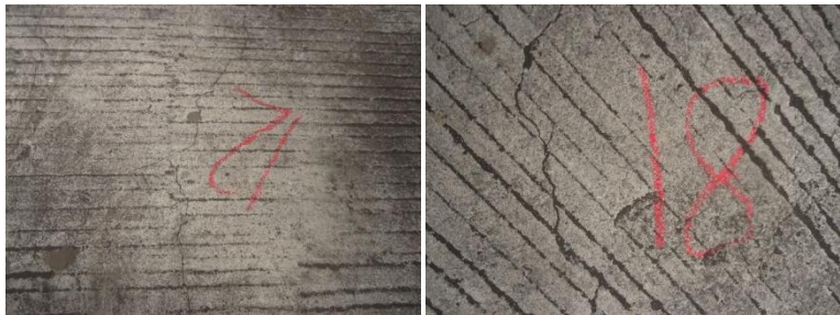
Gambar 4.3 Retak diagonal pada plat lantai trestle
