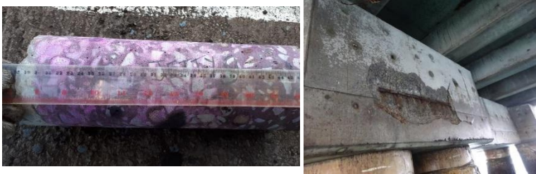
Gambar 8.24 Uji karbonasi dan spalling selimut beton
