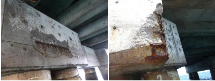
Gambar 4.7 PileCap beton keropos dan tulangan terkorosi
