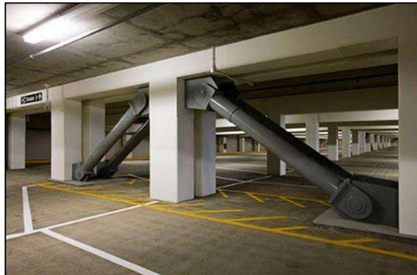
Gambar 1 Fluid Viscous Damper Pada Bangunan (Mundo Del, 2017)
