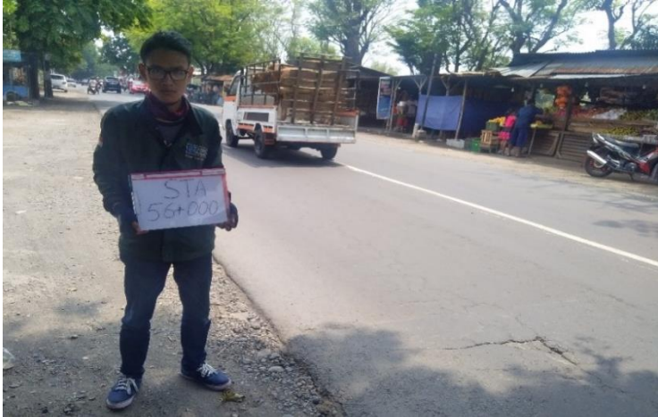
Gambar 1.10 Kondisi Jalan STA 56+000 Sumber: Dokumen Pribadi
