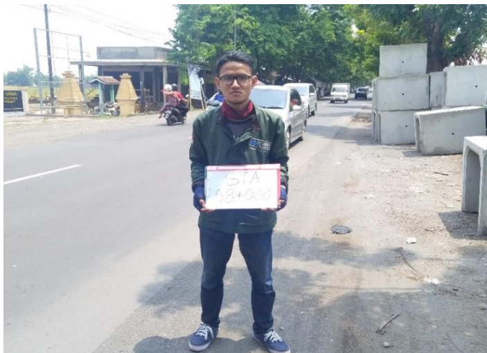
Gambar 1.13 Kondisi Jalan STA 58+000
