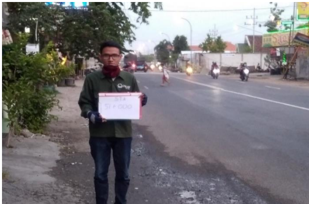
Gambar 1.3 Kondisi Jalan STA 51+250
