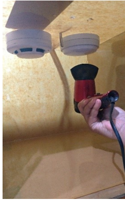
Gambar 4.5 Pengujian Heat Detector
