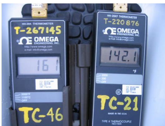
Gambar 0.3 K-Unit thermal couple yang dipasang pada inlet dan discharge menuju dan dari Heat exchanger
