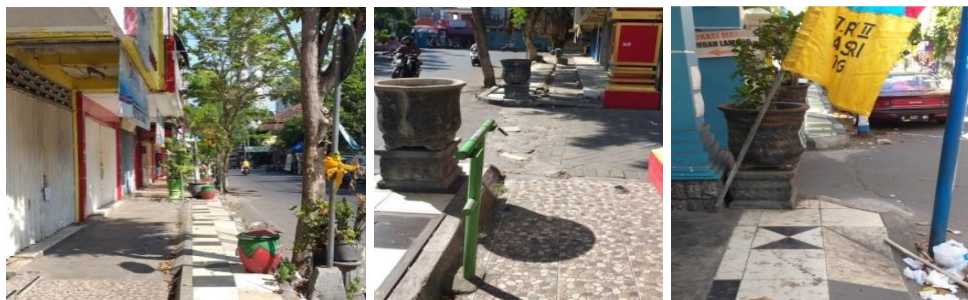
Gambar 4.20 Permasalahan Elevasi Lantai dan Pembatas dengan Jalan (Observasi Lapangan, 2019)
