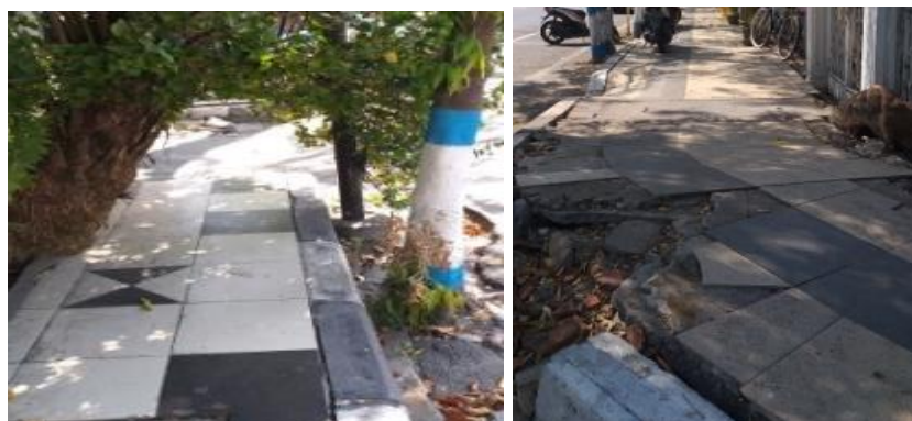
Gambar 4.21 Permasalahan Penutup Lantai Rusak dan Terhalang Vegetasi (Observasi Lapangan, 2019)
