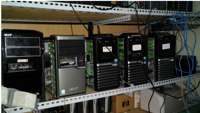
Foto Backup Server
