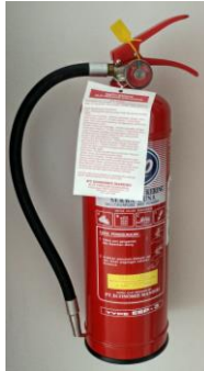
Fire extinguisher di beberapa tempat di gedung A & B
