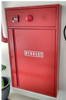
Selang hydrant di beberapa tempat di gedung A & B
