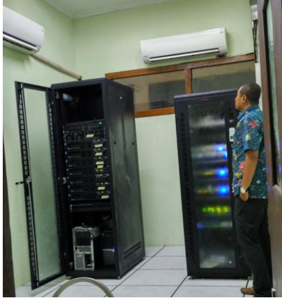
Foto Ruang Server
