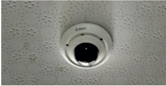
Kamera CCTV di beberapa tempat di gedung A & B
