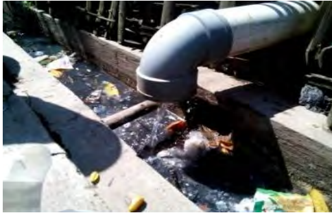
Gambar 5. 1 Kondisi Outlet di Jl. Keputih Tegal 7 No. 2
