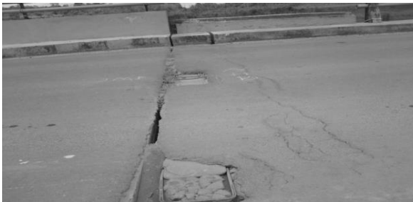
Gambar 2.1 Kerusakan yang terjadi pada expansion joint Sumber : Departemen PU
