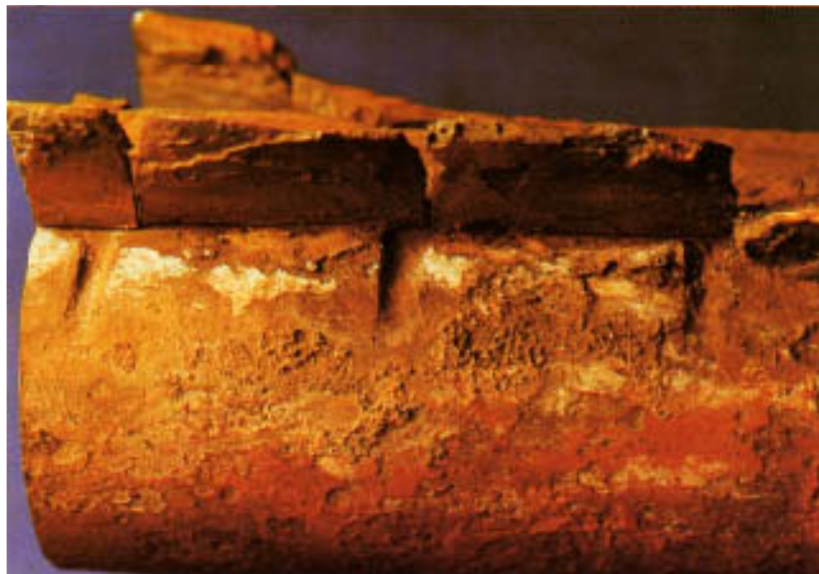
Gambar 2.3 Cerukan Dalam pada Sisi Panas dari Tube Waterwall . (Sumber: Nalco Guide to Boiler Failure Analysis , 1991)[5]
