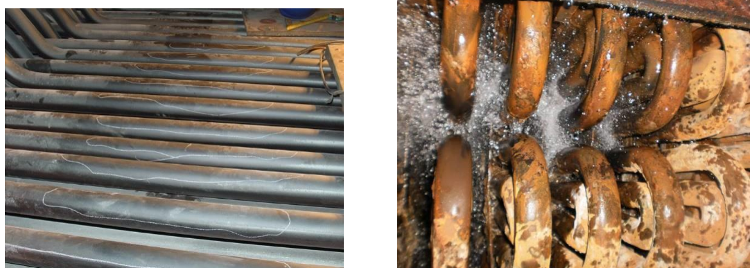
Gambar 2.10: Kerusakan tube akibat erosi sootblower dan fly ash
