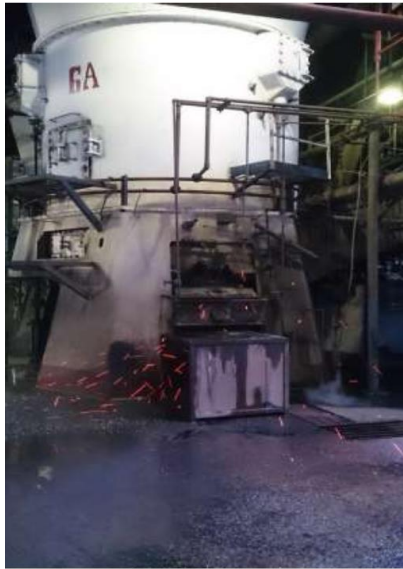
Kondisi Pulverizer Unit 6
