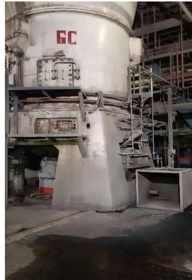
Kondisi Piryte box Pulverizer
