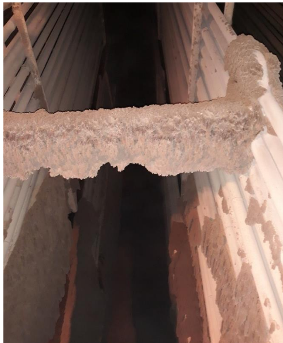
Gambar 2.2 Slagging di Boiler (Suralaya, 2018)
