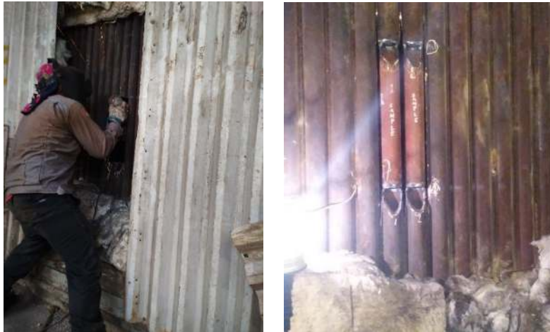
Gambar 3.4 Metode pengambilan dan penggantian sample tube Boiler
