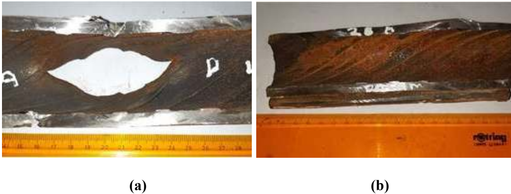
Gambar 4.12 Pengamatan visual dinding bagian dalam tube bocor Code L8; (a) dinding bagian dalam (b) dinding posisi 180° dengan area bocor
