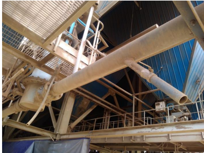
Gambar 3.7 Foto lokasi pengambilan sampel fly ash di hopper ESP.
