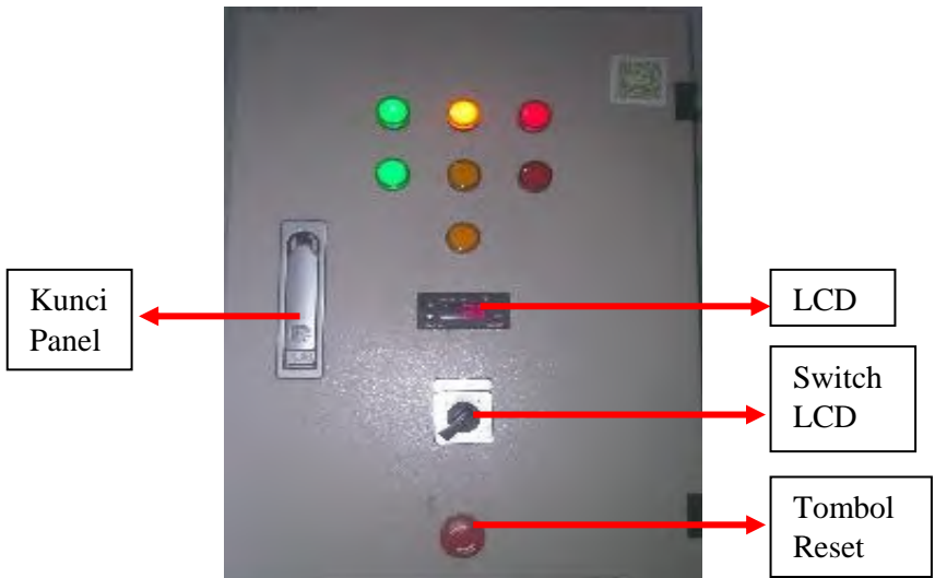
Gambar IV. 11 Tampak depan Panel MCB 2
