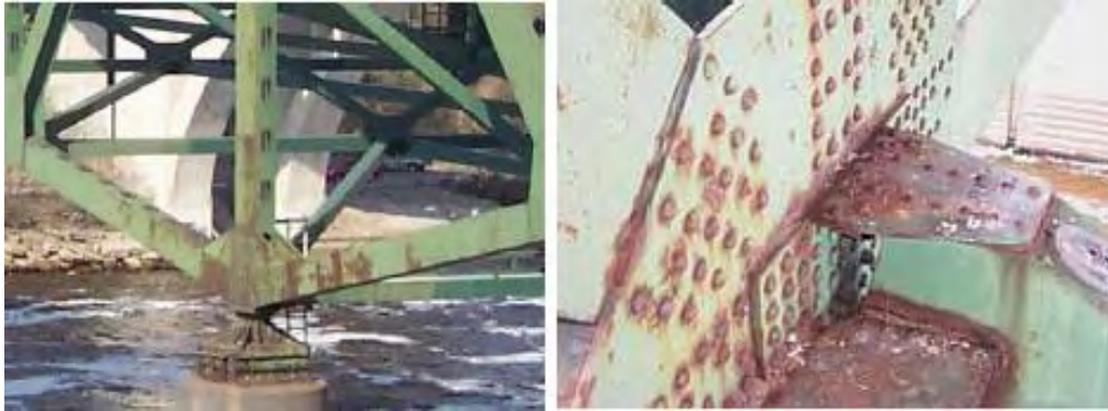
Gambar 2.4 Korosi Pada Roller Bearing dan Plat Buhul
