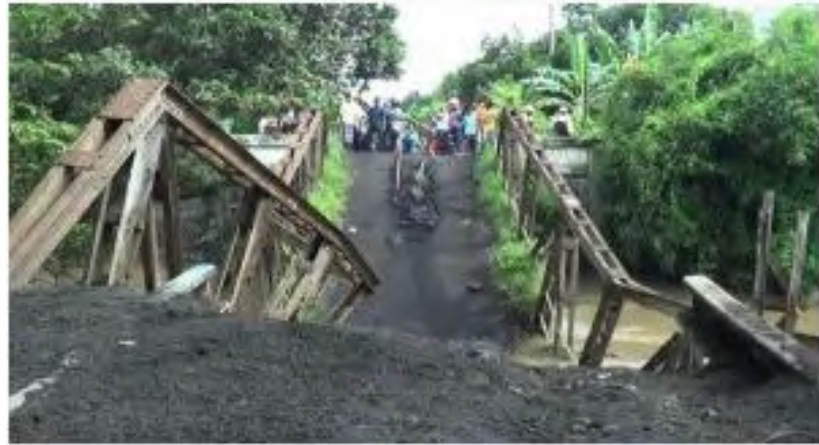
Gambar 1.1 Keruntuhan Jembatan di Probolinggo
