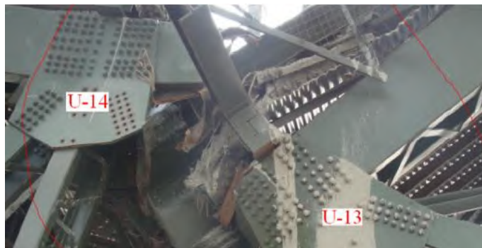
Gambar 2.16 Kerusakan Plat Buhul pada titik U13 dan U14
