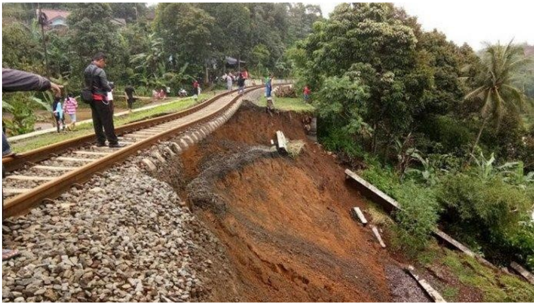
Gambar 1.2 Kelongsoran hanya terjadi di tempat tertentu di perbukitan sepanjang trase jalan raya atau jalan kereta api (Mahatma, F., 2019)
