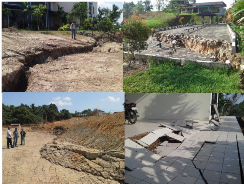
Gambar 5.3. Kerusakan bangunan disekitar akibat terjadinya pergerakan tanah dan kelongsoran
