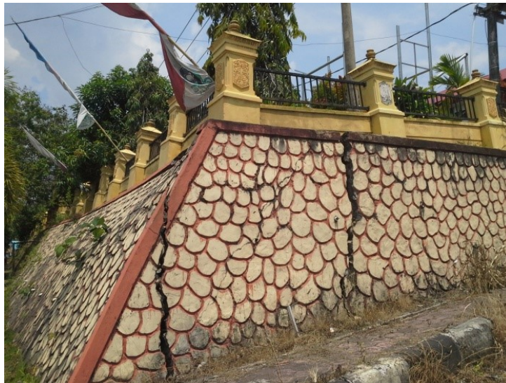
Gambar 5.2. Retak pada bangunan disebabkan oleh adanya pergerakan tanah pada pasangan batu kali penutup pagar Politeknik Negeri Balikpapan
