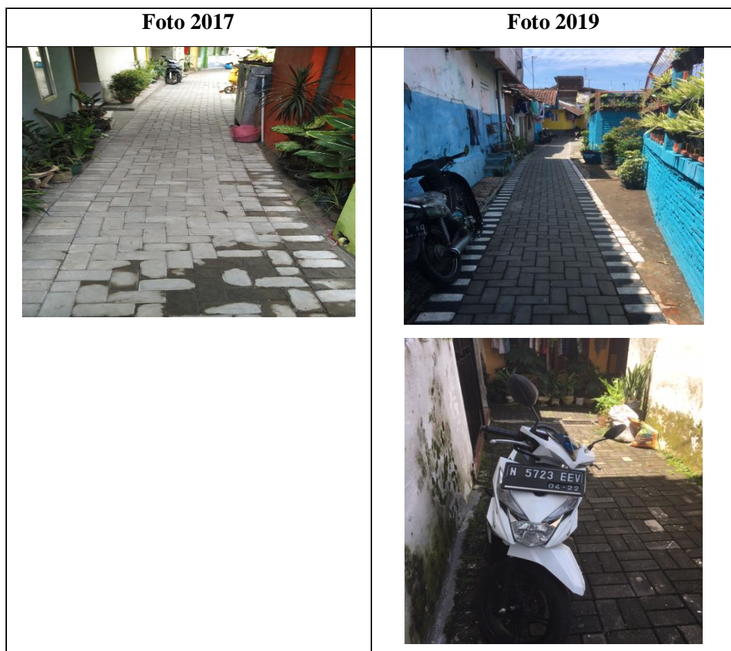
Gambar 4-4 Kondisi Jalan Eksisting di Kelurahan Kasin
