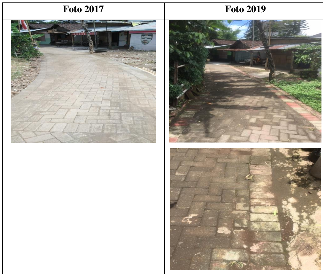
Gambar 4-7 Kondisi Jalan Eksisting di Kelurahan Bareng
