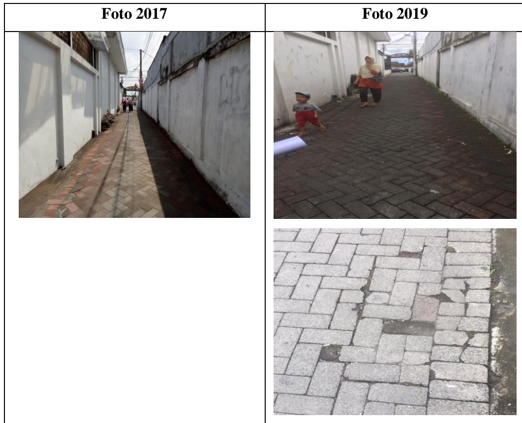
Gambar 4-11 Kondisi Jalan Eksisting di Kelurahan Penanggungan
