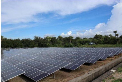
Gambar 2.5 Pembangkit Listrik Tenaga Surya
