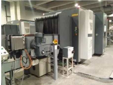
Gambar 2. 5 Mesin X-Ray Scanner pada unit BHS Terminal 3 Bandar Udara Soekarno Hatta
