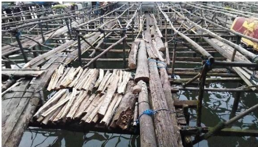
Gambar 4. 50 Lantaran yang sudah rusak Sumber : Survey Primer, 2020
