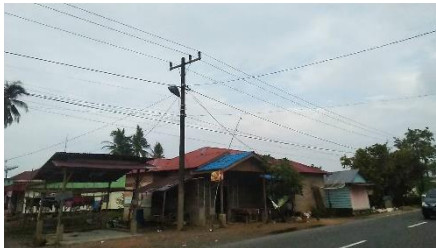
Gambar 4. 6 Jaringan Listrik di Jalan Padang Sidempuan
