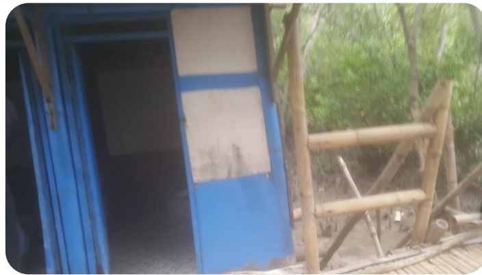
Gambar 4. 10 Toilet di Lokasi Wisata (dokumentasi pribadi)
