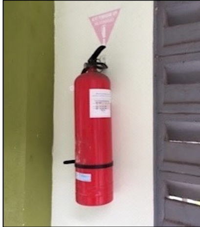
Gambar 4.8 Kondisi APAR di AM ITS
