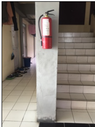
Gambar 4.22 Kondisi APAR di AM UPN
