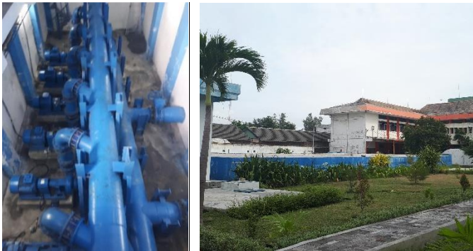
Gambar 2.6 Bangunan Ground Reservoir Krembangan dan Pompa
