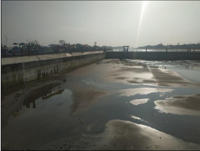
Gambar 3.8 Bak Sedimen Sumber: Dokumentasi Penulis
