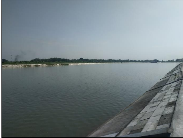
Gambar 3.6 Kolam Penampungan 2 Sumber: Dokumentasi Penulis
