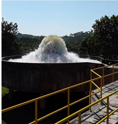
Gambar 2.9 Aerator IPAM KP III Sumber: Paitaha dan Sholihah (2019).
