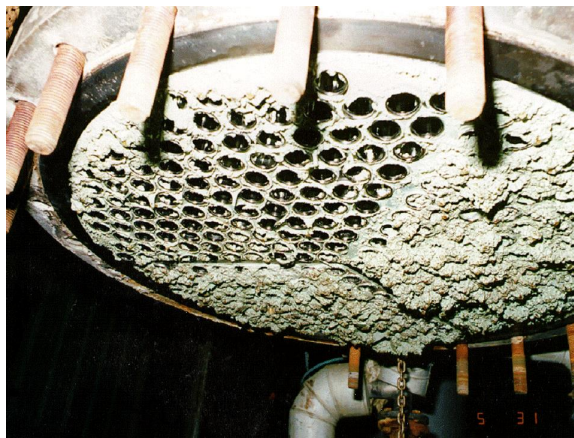
Gambar 2.11 Fouling pada permukaan heat transfer shell and tube
