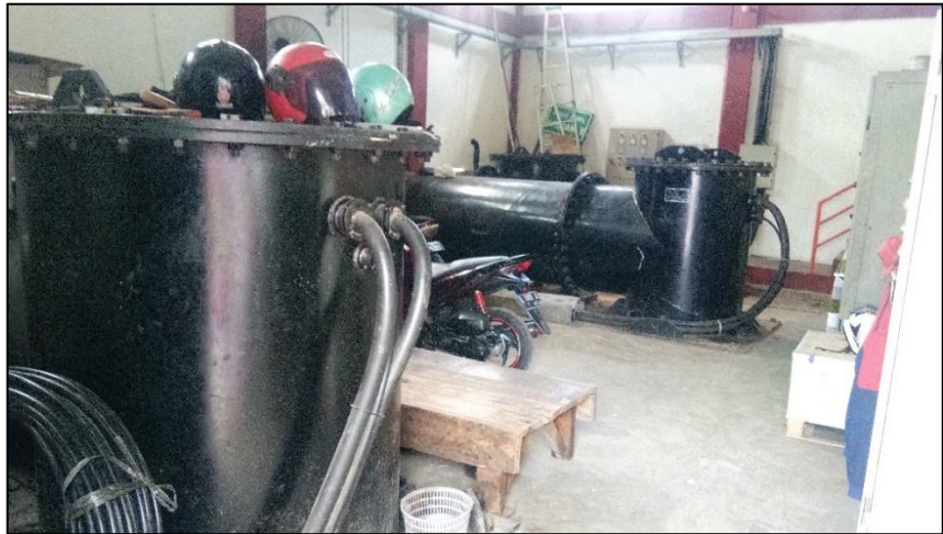
Gambar 3.2 Pompa air di dalam rumah pompa
