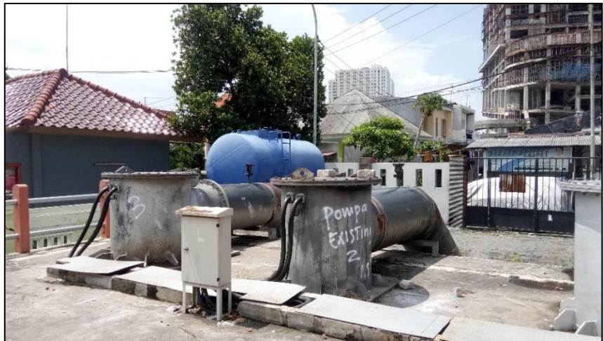
Gambar 3.3 Pompa air di bagian luar
