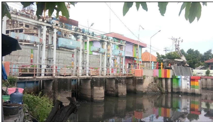
Gambar 3.1 Pintu air Kalidami
