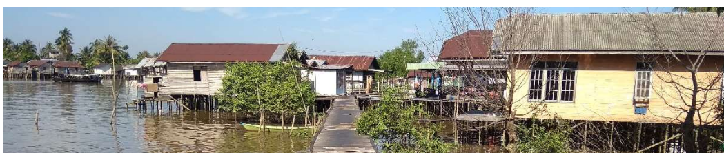
Gambar 4.11. Kondisi titian yang mengalami kerusakan.
