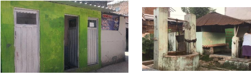
Gambar 4. 43 Kondisi WC Umum Pada Permukiman Kumuh DAS Metro
