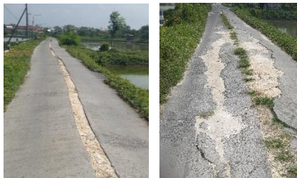
Gambar 4. 27 Kondisi Jalan Desa di Kecamatan Glagah
