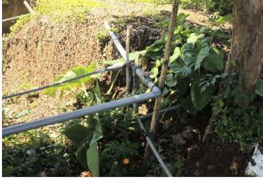
Gambar 4.52 Pipa Saluran Air Kolam Renang Atas Awan
