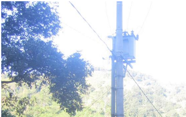
Gambar 4.53 Infrastruktur Listrik di Desa Wisata Jembul
