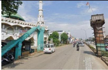
Gambar Jembatan Penyeberangan Orang (JPO) yang Terbengkalai Pada Segmen 4.
