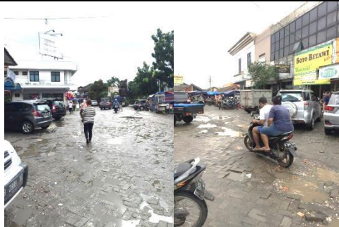
Gambar Masalah Jalan Lingkungan yang Rusak Pada Segmen 4.
