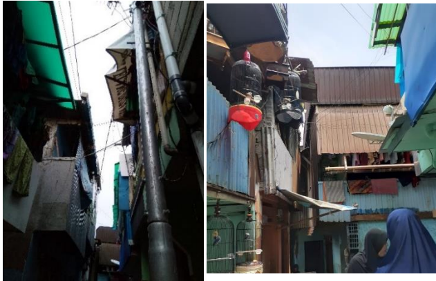
Gambar 4. 8 Kondisi Struktur bangunan
