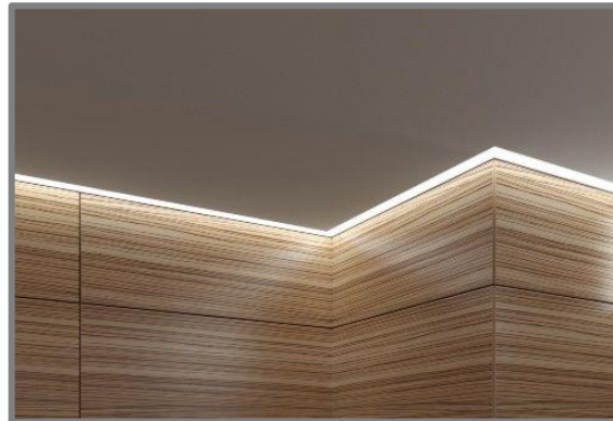
Gambar 2. 29 Perimeter Lighting pada Drop Ceiling Sumber: google.com (2020)
