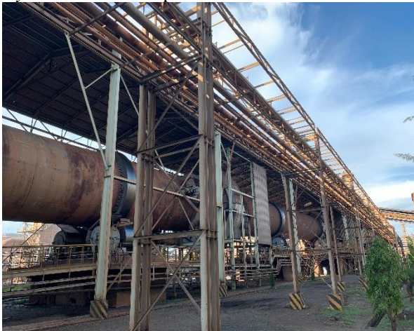
Gambar 2.5 Rotary Kiln (sumber : dokumentasi pribadi)
